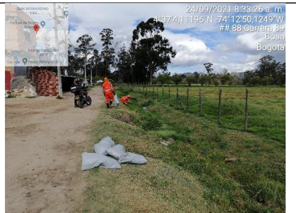
Se evidenció recolección de residuos sólidos en el canal perimetral del sector 1 PEDHLS.
