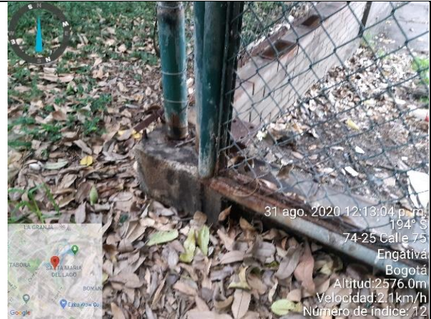
Imagen 5 falta de mantenimiento de malla perimetral eslabonada en zona sur
