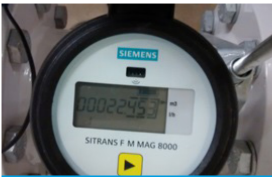
Medidor con sistema magnético de medición en metros cúbicos (m 3 ).
