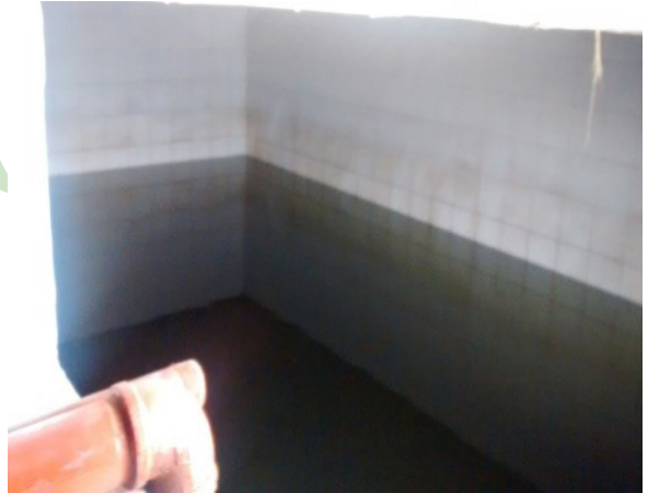
Tanque de almacenamiento de agua lluvia y de riego ubicado en el sótano.
