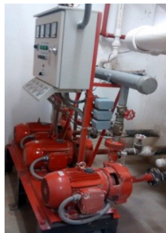
Sistema eléctrico de bombeo.
