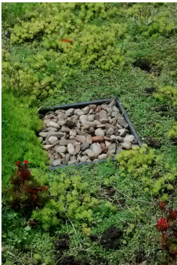
Sifón de recolección de agua lluvia y riego en techos verdes.
