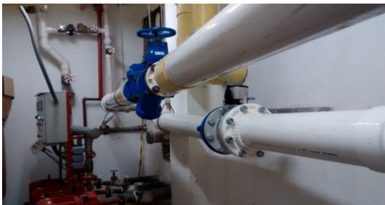
Medidor de captación de agua lluvia.
